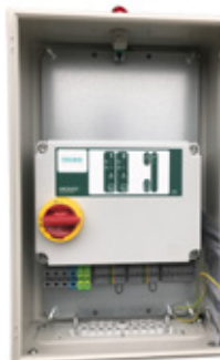
Kontrollenhet för 1 pump (uthusskåp) med ljus och ljud
