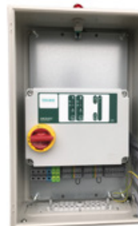
Kontrollenhet för 2 pumpar (uthusskåp) med ljus och ljud
